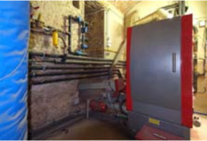
Eau chaude solaire collective - FRÉJUS
