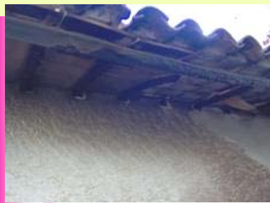
habitation touchée extérieurement
