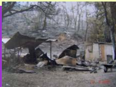
dégâts à une installation périphérique à l'habitation
